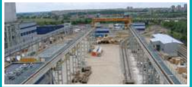
Hệ thống cáp ngầm tại nhà máy Underground cable system in factory
